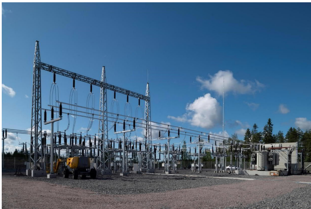
Kuva 3-2. Esimerkki tuulivoimahankkeen sähköasemasta. © Ilmatar Energy Oy.
